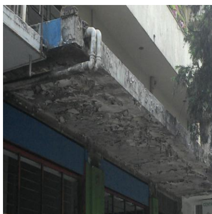
Figura 3 - Marquise com infiltração e esfoliação da pintura.
