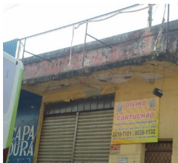
Figura 2 - Marquise de uma sala comercial sem nenhuma manutenção e com infiltração.
