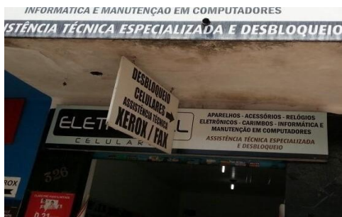
Figura 1 - Marquise com mofo e infiltração.
