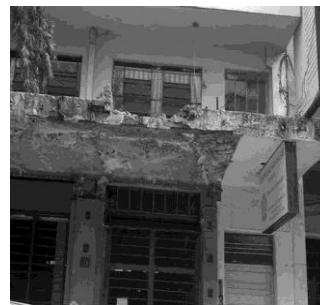
Figura 4 - Marquise com destacamento do concreto.
